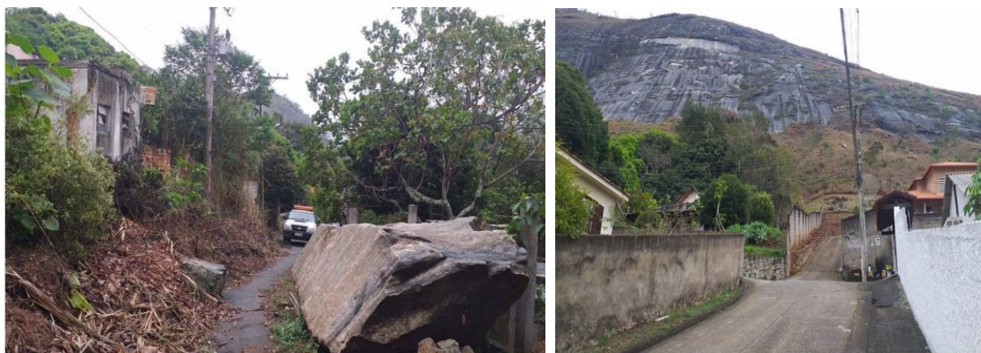
Figura 08: Deslocamento de Rochas - Estrada da Pedreira, Posse. (Fonte: SEMPDEC, 2022).
